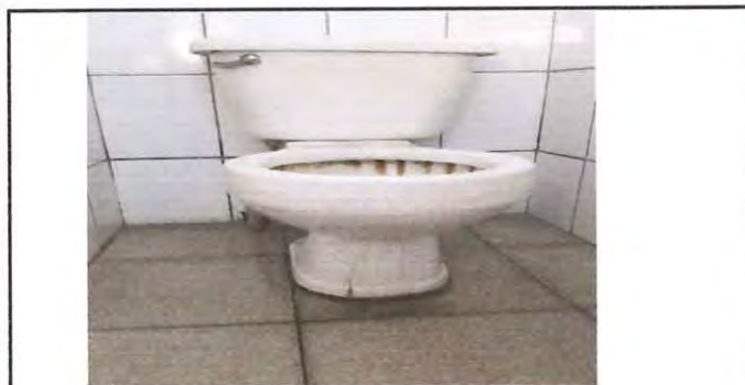
Foto: 5 Se necesitan cambiar los sanitarios en baños de niñas
