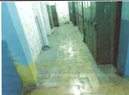
Foto 2: Piso del pasillo lado oeste-sur
