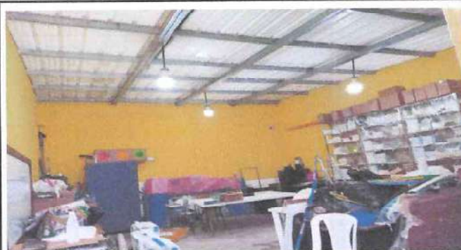
Foto: 2 Aula No. 8 cerrido e impermeabilización, se humedecen mucho las paredes y los muebles.
