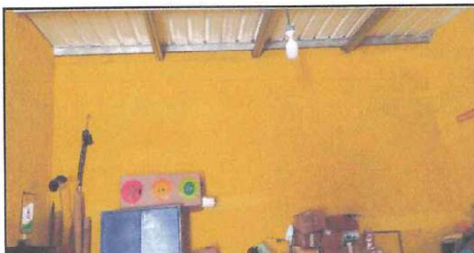
Foto 3. Aula No. 8 pared humeda
