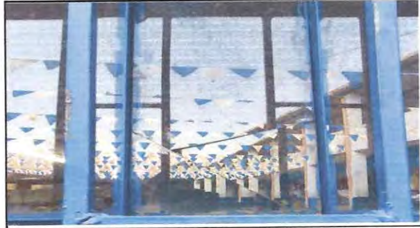
Foto: 4 Aca podemos observar que varios vidrios de algunas ventanas se encuentran quebrados lo cual requiere un cambio.
