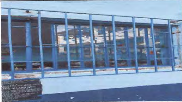
Foto: 1 En esta fotografía vemos que las ventanas ya se encuentran deterioradas en la cual se necesita un cambio.
