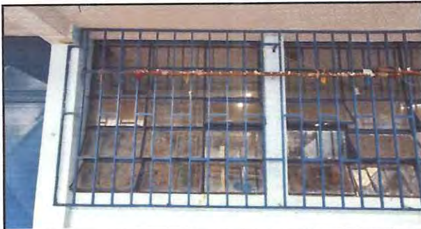
Foto: 3 Podemos observar que en estos ventanales carecen de ventilación ya que no se pueden abrir las ventanas provocando un salón muy caluroso.
