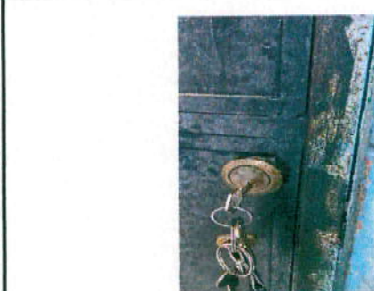
Foto 2: 4.2 Sustitución de Chapa; la chapas ya no echa llave en una aula y
