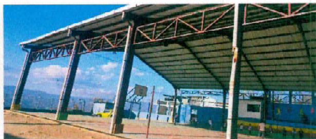
Foto 2. 7.3 Reparación de bajadas de agua pluvial en la cancha ya están quebradas y deterioradas. En poca de lluvia afecta la caída de agua
