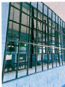
Foto 3: 5.7 Mantenimiento a balcones de Metal, ya se encuentran muy despintadas y algunas partes presentan oxido
