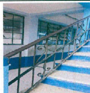
Foto 4: Mantenimiento de barandas de metal; las barandas ya se encuentran en mal estado, oxidadas y despintadas.
