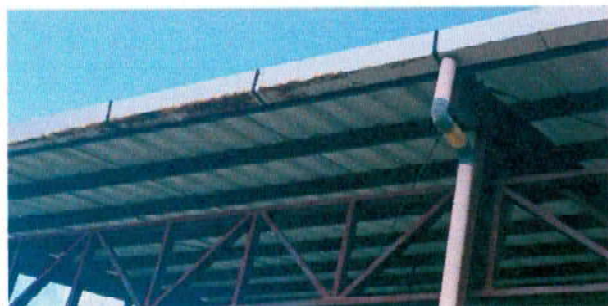
Foto 1. 7.1 Sustitución de canal de metal; gran parte se encuentra oxidado y con agujeros. En época de lluvia cae agua por los canales
