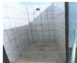
Foto 6: Ducha a sustituir por sanitario.
