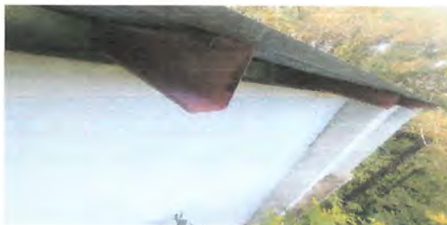
Foto 3: Instalación de tapaluz en Agujero entre pared y lámina.
