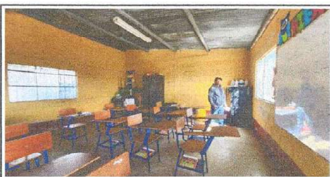
Foto 10: Imagen donde se observa el estado actual del aula del módulo 1.
