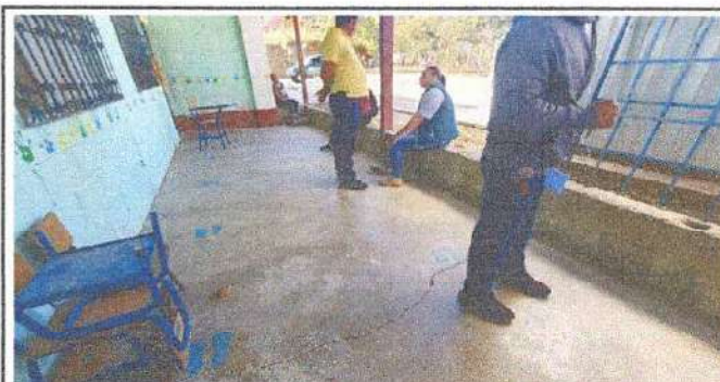
Foto 4: Imagen donde se observa el estado actual del piso del corredor del aula del módulo 1.
