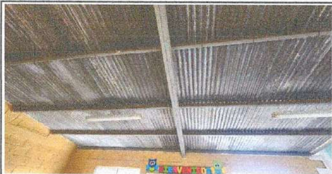
Foto 1: Imagen donde se observa el estado actual de las lamparas de las aulas del módulo 1.
