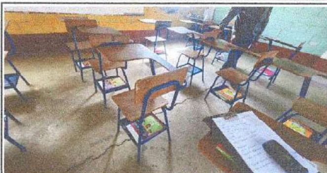
Foto 2: Imagen donde se observa el estado actual del piso de las aulas del módulo 1.
