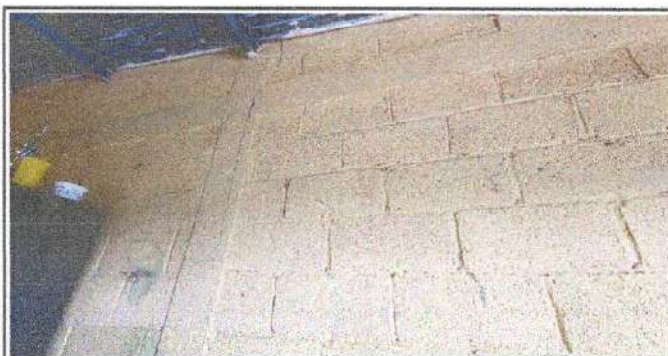
Foto 9: Imagen donde se observa el estado actual de las grietas en el muro del aula del módulo 1.
