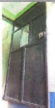
Foto 3: Sustrucción de la puerta de Cuarto A
