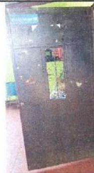
Foto 4: Sustrucción de la puerta de Tercero C
