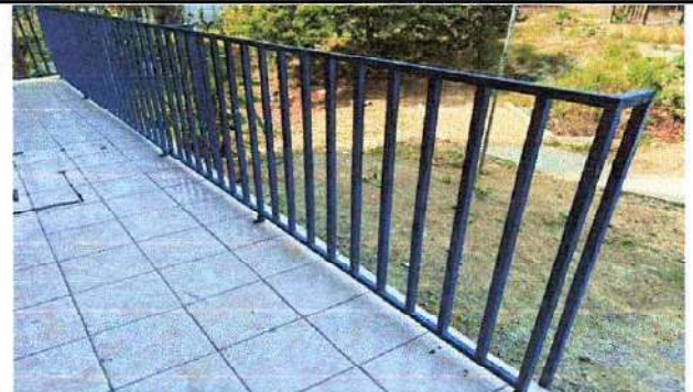
Foto 4: Imagen donde se observa el estado actual de las barandas de metal del centro educativo.
