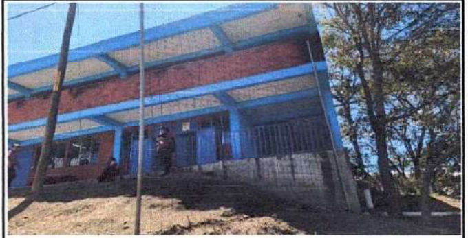
Foto 8: Imagen donde se observa el estado actual del ingreso del centro educativo.
