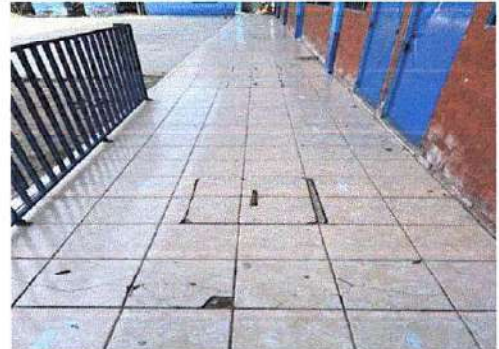
Foto 2: Imagen donde se observa el estado actual del piso del corredor del centro educativo.
