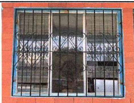
Foto 15: Imagen donde se observa el estado actual de los vidrios de las ventanas.
