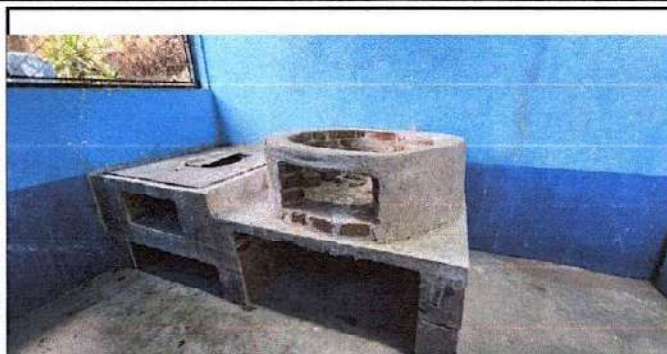
Foto 14: Imagen donde se observa el estado actual de la estufa rural de cocina.
