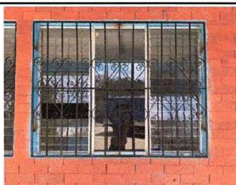
Foto 16: Imagen donde se observa el estado actual de los vidrios en otra las ventanas.
