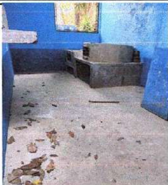
Foto 13: Imagen donde se observa el estado actual del piso en cocina.
