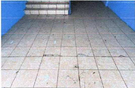
Foto 1: Imagen donde se observa el estado actual del piso del corredor del centro educativo.
