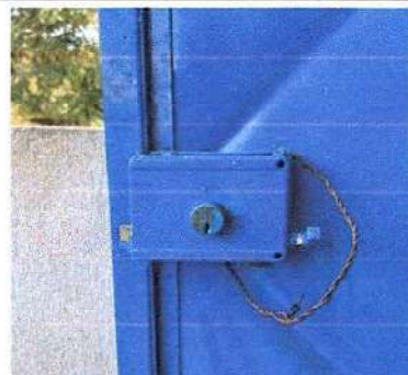
Foto 6: Imagen donde se observa el estado actual de las chapas de las puertas de las aulas.
