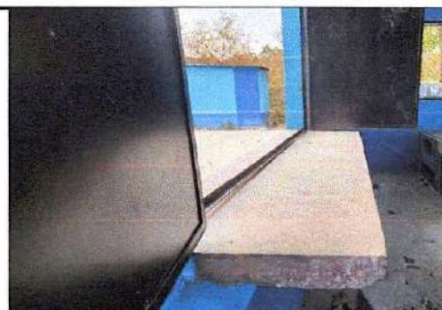
Foto 17: Imagen donde se observa el estado actual de mesa de concreto en cocina.
