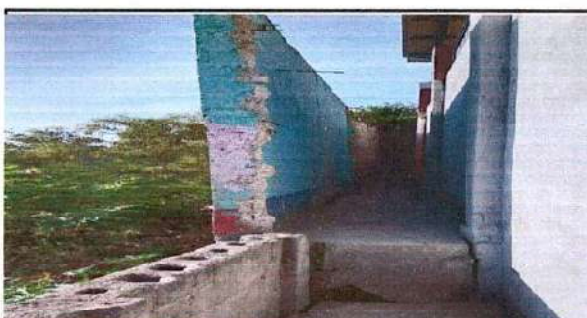
Foto 4: area muro contencion riesgo de colapso lado este.
