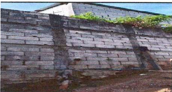
Foto 5: area del muro contencion presenta fisuras representa peligro para niñas y niños en epoca de lluvia.
