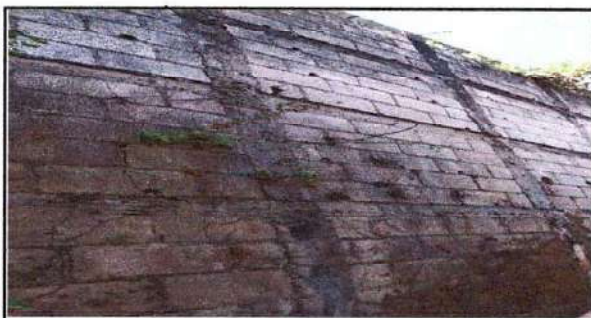
Foto 3: muro contencion lado por cocina 7 mts. largo x 6 mts de alto lado norte presenta fisuras representa peligro.
