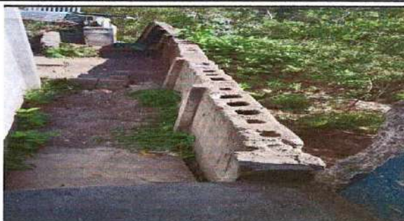
Foto 2: muro contencion representa peligro en epocas de lluvia para niñas y niños.
