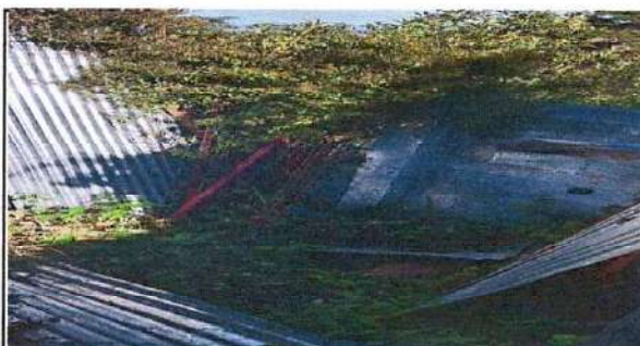
Foto 6: Muro de contencion lado cocina es necesario rellenar con selecto nivlear el area.
