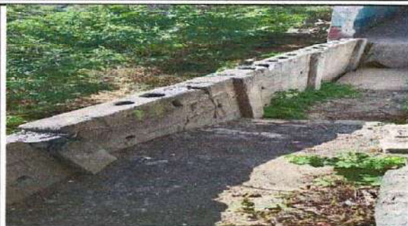
Foto 1: muro de contencion lado este de escuela 7 mts largo x 3.50 mts. alto a punto de colapsar
