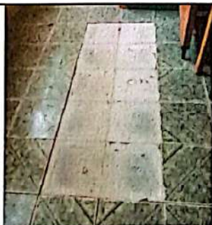
Foto 3: Algunas áreas del salón de párvulos, el piso está completamente desprendido.
