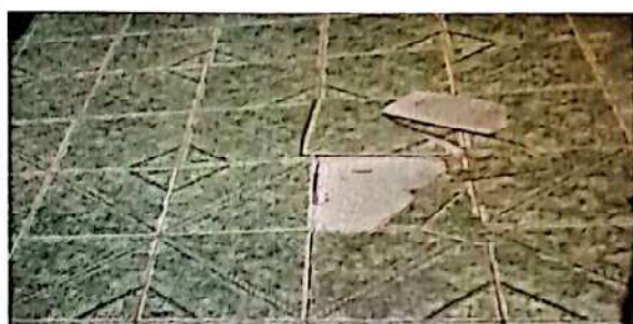
Foto 2: El piso del salón de clases de párvulos 2 se encuentra en deterioro significativo.
