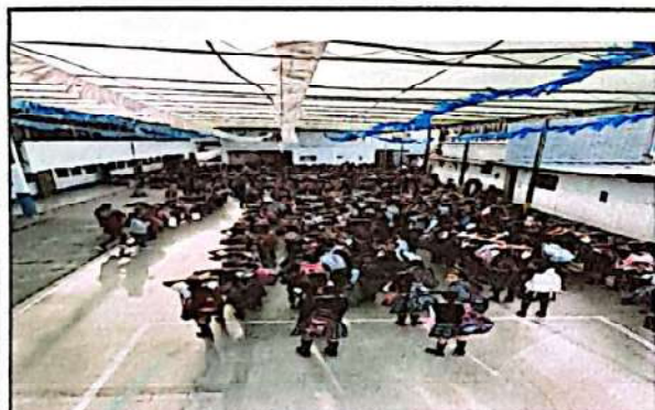
Foto 3: aca se observa como el aire y la lluvia an deteriorirado la parte de arriba de l techo, donde segun el estudio este verano e invierno ya no aguantara.
