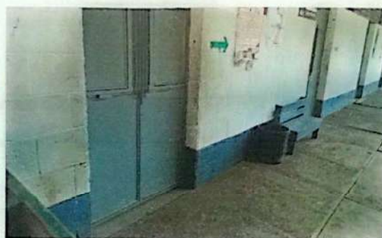
Foto 6: El dejar las puertas de los salones de clases sin mantenimiento provocará que estas se deterioren y afecte su vida útil.
