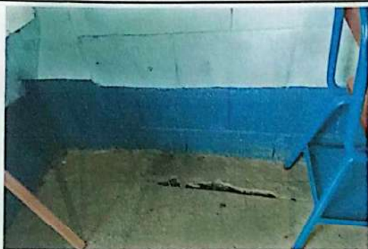
Foto 3: Las grietas de los salones de clases han provocado que los estudiantes sufran accidentes.
