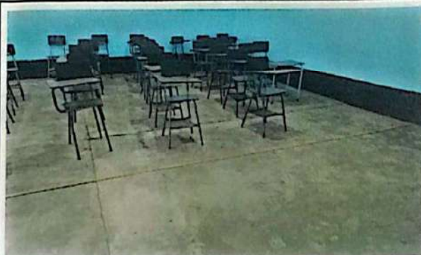
Foto 2: El piso de los salones de clases se encuentran en malas condiciones estas presentan rajaduras y grietas.
