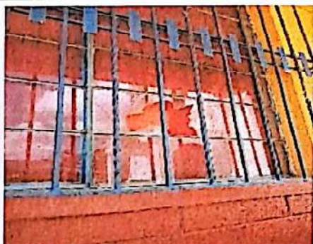
Foto 9: Módulo 1 sustitución de vidrios y ventanas en los salones debido a que se encuentran quebrados. Esto representa peligro para los estudiantes.
