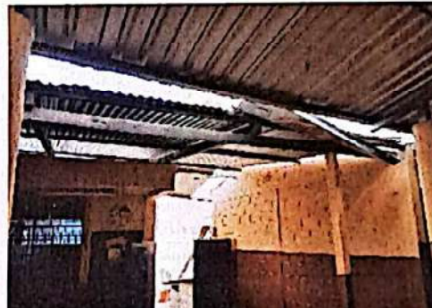
Foto 10: Módulo 3 sustitución y reparación de canales de agua frente a los salones ya que cuando los estudiantes realizan actividades en el área y en la época de invierno se filtra la lluvia.
