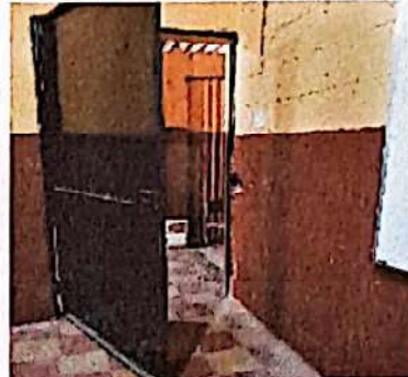
Foto 8: Módulo 3 Reparación de puertas de los salones de clase, debido a que se encuentran en mal estado
