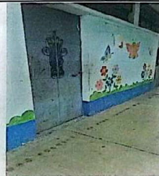
Foto 10: La falta de mantenimiento de las puertas metálicas de los salones de clases, ha provocado que el metal se vaya desgastando paulativamente, acortando su vida útil.
