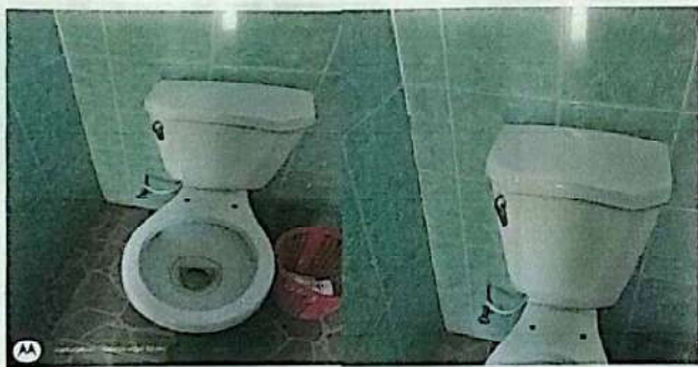
Foto 3: El servicio sanitario para niños y niñas se encuentran en malas condiciones, los sanitarios se encuentran en malas condiciones, no cuenta con agua de forma directa en cada una de ellas.
