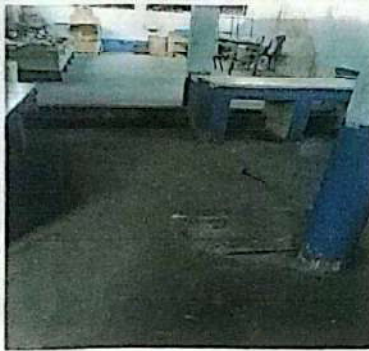
Foto 9: El desgaste del piso de cocina impide que se realice la limpieza a profundidad.
