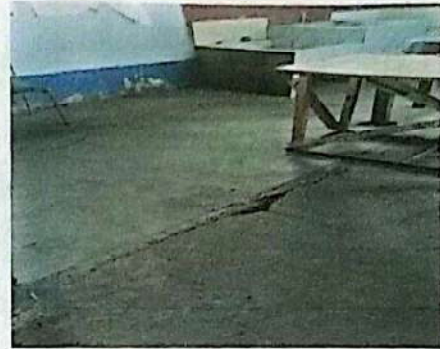
Foto 8: El piso de la cocina es de cemento; se encuentra en mal estado, esto da la pauta a posibles accidentes debido al desnivel y grietas de la misma.
