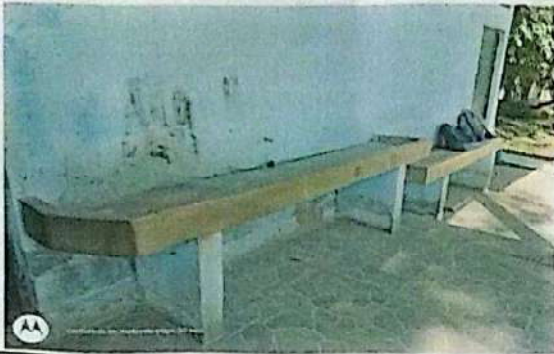
Foto 7: Los lavamanos están elaborados de cemento, los chorros se encuentran deshabilitado debido al mal estado, dificultando el correcto lavado de las manos.
