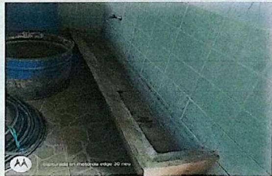
Foto 4: El mingitorio del baño de niños actualmente es de cemento, debido al poco mantenimiento se ha obstruido varias veces el paso del agua.
