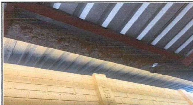
Foto 4: LOS CANALES ESTÁN DETERIORADOS
