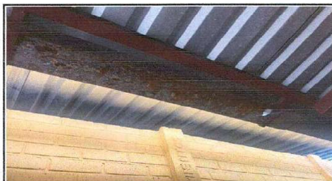
Foto 4: LOS CANALES ESTÁN DETERIORADOS
