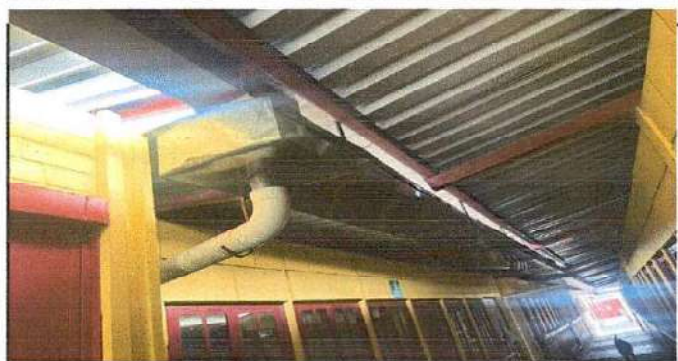
Foto 6: LOS CANALES ESTÁN OXIDADOS Y SE CUELA EL AGUA
