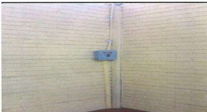
Foto 3: LAS PAREDES SE RAJARON
