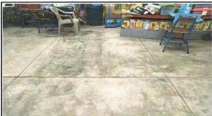
Foto1: AULA PRIMER NIVEL PISO DETERIORADO POR ANTIGÜEDAD.
