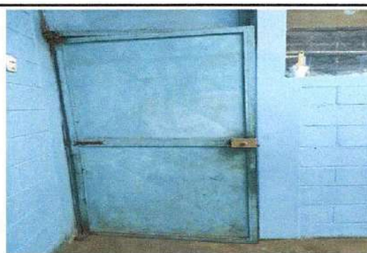
Foto 4: Puerta por lado dentro, primer nivel con necesidad de sustitución.
