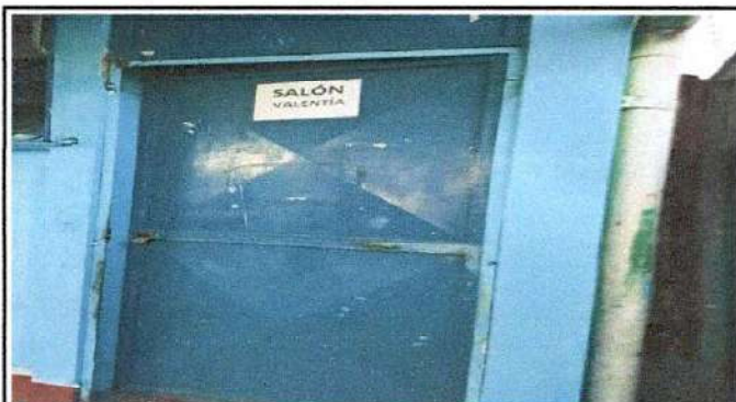
Foto 3: Puerta de salon de clases primer nivel en condiciones de atención urgente.
