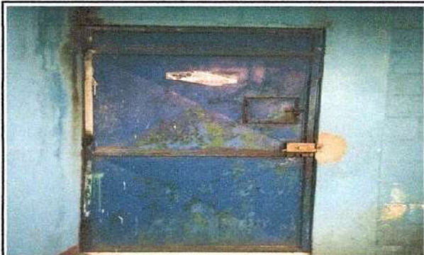
Foto 1: Necesidad de cambio de puerta principal, por deterioro.
