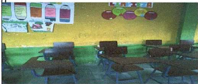
Foto 1: AULA PRIMER NIVL CON NECESIDAD DE PINTURA POR DENTRO.
