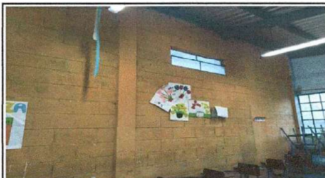
Foto 4: TRES SALONES DE CLASES DEL SEGUNDO NIVEL CON NECESIDAD DE APLICACIÓN DE PINTURA EN PAREDES PARA MEJORAR AMNBIENTE DE TRABAJO.
