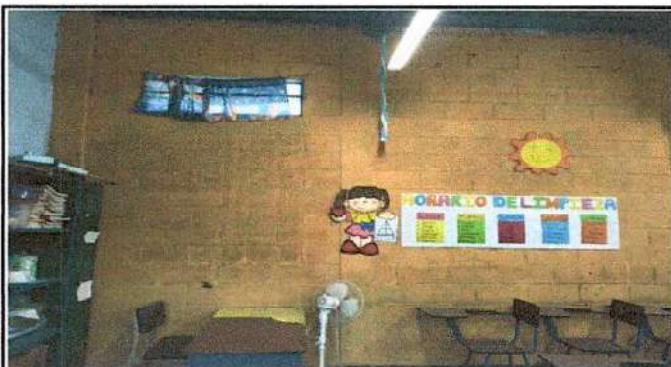
Foto 3: PAREDES MANCHADAS CON NECESIDAD DE APLICACIÓN DE PINTURA.
