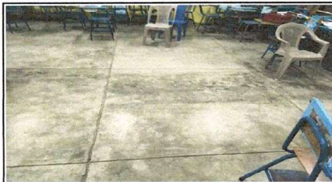
Foto 2: NECESIDAD DE SUSTITUIR PISO DE CONCRETO PARA MEJORAR AMBIENTE DE TRABAJO.
