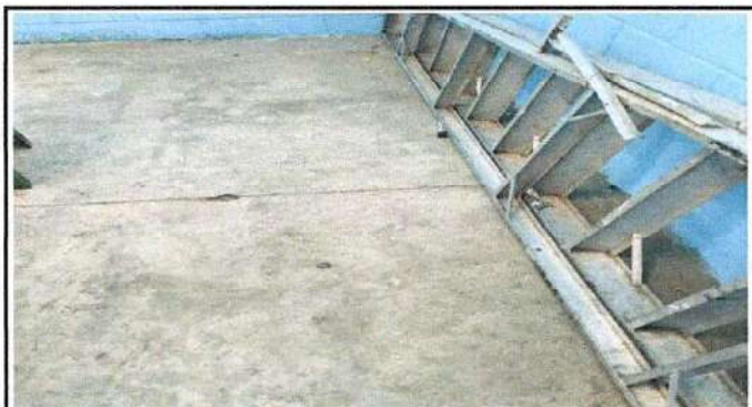
Foto 3: Necesidad de sustitucion de piso por deterioro.
