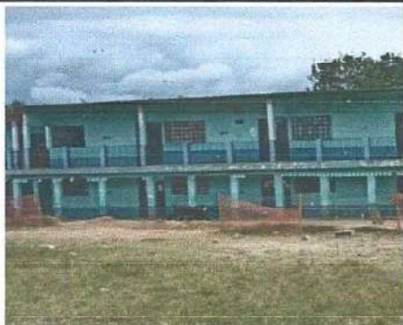
Foto 1: PINTURA DE LA ESCUELA TODA EL ÁREA DEL EXTERIOR YA TIENE MUCHOS AÑOS DE QUE NO SE PINTA
