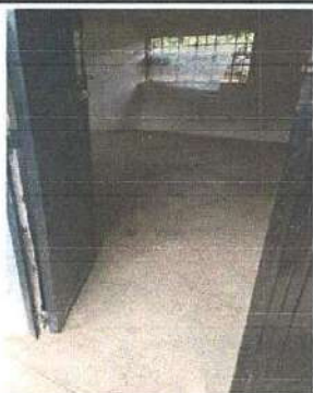
Foto 3: A RAIZ DE LA SUSTITUCION DEL PISO SE TENDRAN QUE HACER UN AREGLO A LAS PUERTAS YA QUE CON EL NUEVO PISO NO CERRARAN LAS PUERTAS
