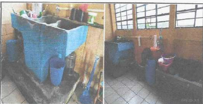
Foto 5: Imagen que muestra el área donde se realizará sustitución de azulejos en cocina y sustitución de pila.
