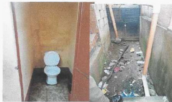
Foto 20: FILTRACIÓN DE AGUA DE LLUVIA EN MURO INTERIOR DE MÓDULO DE SANITARIOS COLINDANCIA EXTERIOR MÓDULO 2. RENGLÓN 9. ARCHIVO ESCUELA.
