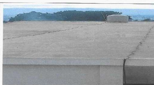
FOTO 4: GRIETAS EN TERRAZA MÓDULO 3. RENGLÓN 1. ARCHIVO ESCUELA
