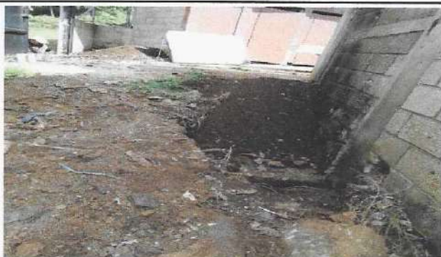
Foto 13: CAJA DE REGISTRO DE DRENAJE DE MINGITORIO. RENGLÓN 6. ARCHIVO ESCUELA.
