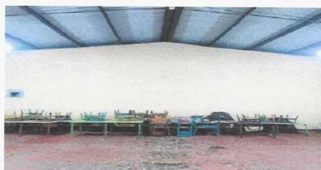
Foto 8: PISO DE CEMENTO DETERIORADO AULA 2 MÓDULO 5 42 M2. RENGLÓN 3 . ARCHIVO ESCUELA.
