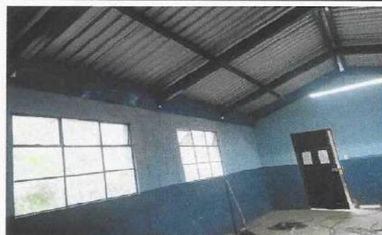
Foto 16: AULA DE MÓDULO 4 CON CABLEADO ELÉCTRICO DETERIORADO. RENGLÓN 8. ARCHIVO ESCUELA.
