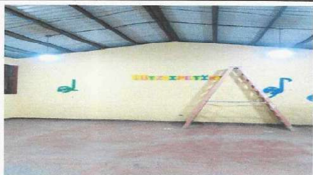
Foto 9: PISO DE CEMENTO DETERIORADO AULA 2 MÓDULO 5 42 M2. RENGLÓN 3 . ARCHIVO ESCUELA.
