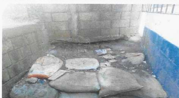
Foto 15: BOQUETE EN BASE DE MURO PERIMETRAL COLINDANTE CALLEJÓN 0, 6M2. RENGLÓN 7. ARCHIVO ESCUELA.
