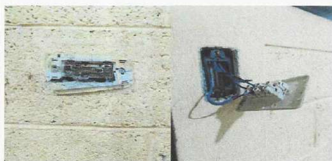
Foto 17: TOMACORRIENTES E INTERRUPTORES DAÑADOS. RENGLÓN 8. ARCHIVO ESCUELA.
