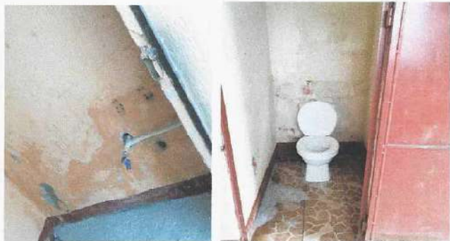
Foto 19: FILTRACIÓN DE AGUA DE LLUVIA EN MURO INTERIOR DE MÓDULO DE SANITARIOS. RENGLÓN 9. ARCHIVO ESCUELA.
