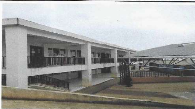
Foto 1: MÓDULO 3, TERRAZA DEL EDIFICIO CON FILTRACIONES DE AGUA DE LLUVIA POR RAJADURAS EN TODA EL ÁREA 320 M2, RENGLÓN 1. ARCHIVO ESCUELA.
