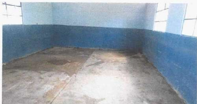
Foto 7 :PISO DE CEMENTO DETERIORADO AULA 1 MÓDULO 4. 42 M2. RENGLÓN 3 . ARCHIVO ESCUELA.
