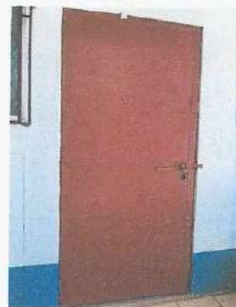
Foto 2: Se procederá a realizar la sustitución de las chapas de las puertas del primer nivel, debido a que presentan deterioro.
