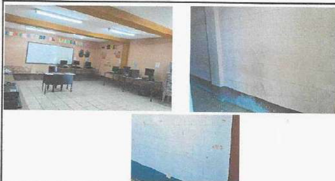
Foto 4: Debido al deterioro que presenta la pintura de los muros interiores y exteriores del establecimiento se procederá a dar mantenimiento.
