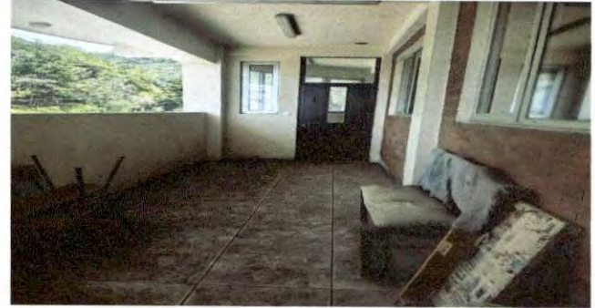
Foto 2: Sustrucción de ventanas muy dañadas por, ventanas de PVC.
