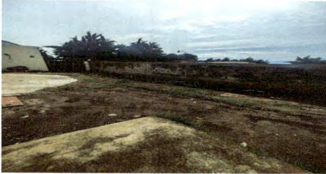
Foto1: Sustrucción de piso de torta de concreto
