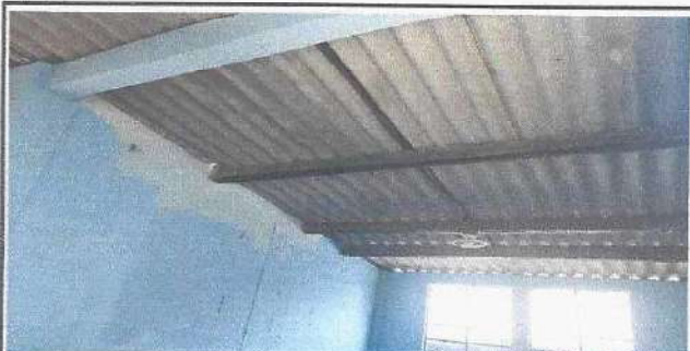
Foto 4: Lámina de duralita en pasillos del segundo nivel con perforaciones
