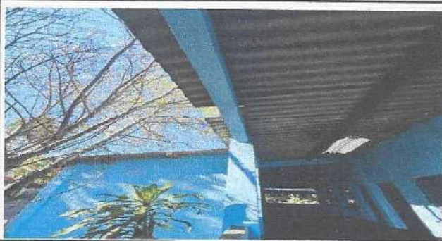
Foto 1: Lámina de duralita con más de 15 años de instalada, ya esta quebrada. Pasillo del segundo nivel.
