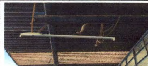
Foto 12: Instalación de luz en corredores
