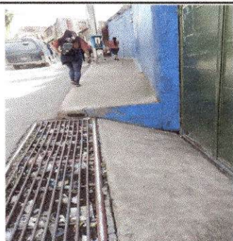
Foto 5: Cuneta - banqueta de concreto
