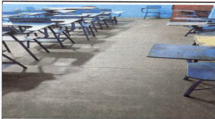
Foto 3: Piso del salón 4
