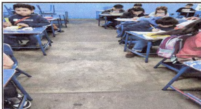
Foto 4: piso del salón 2
