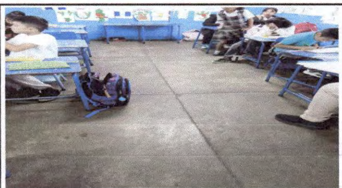
Foto 3: Piso del salón 2
