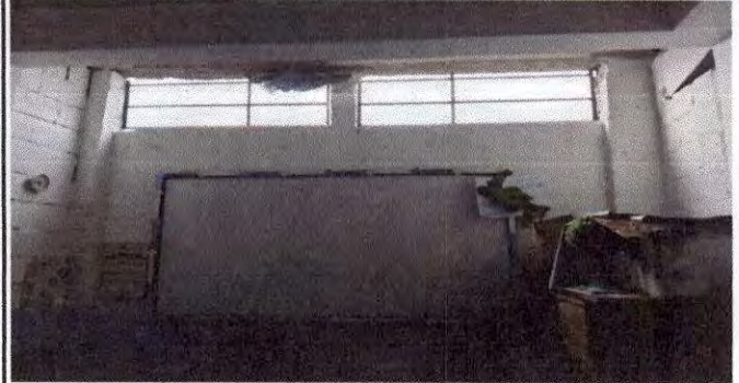
Foto 2: ventanal de atrás, salón 3
