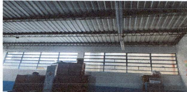
Foto 2: Cambio de ventanas laterales de los salones 3,6 y 7 identificadas en el croquis debido a oxidación y mala ventilación.
