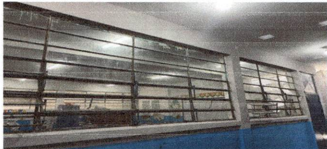
Foto1: Cambio de ventanas frontales de los salones 3,6 y 7 identificadas en el croquis debido a oxidación, mala ventilación.
