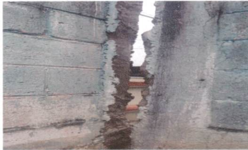
Foto1: Vista desde el exterior del desprendimiento del muro el cual se encuentra sostenido solo con un alambre
