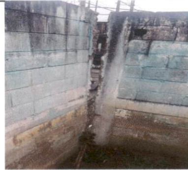
Foto 2: vista desde el interior del deprendimiento del muro el cual esta vencido y por caerse.
