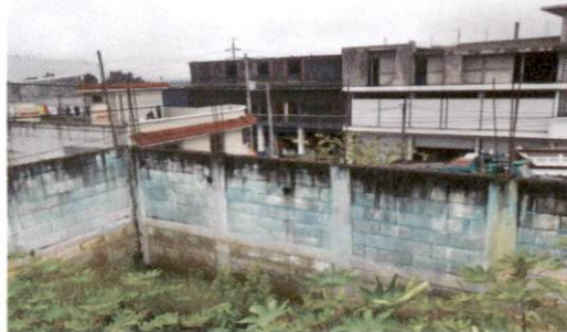
Foto 3: fotografia del area en dimension con el desprendimiento.
