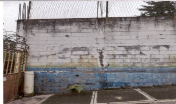
Foto 4: vencimiento del muro y desprendimiento del mismo.
