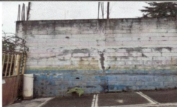
Foto 4: vencimiento del muro y desprendimiento del mismo.
