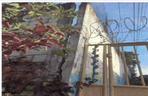
Foto 5: vista desde el exterior lado calle del desprendimiento.
