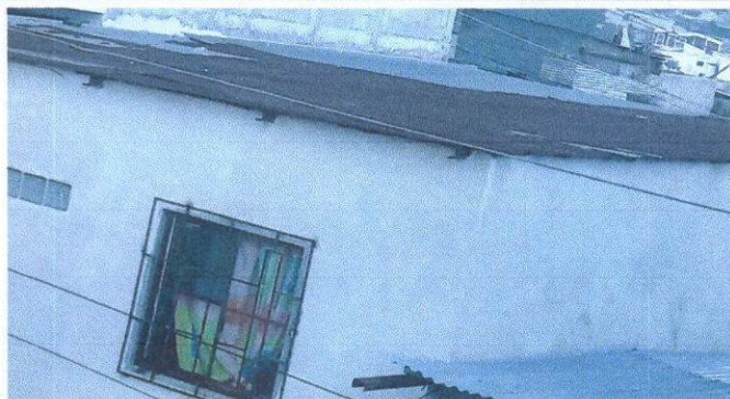
Foto 1: Lamina oxidada que necesita sustituir.
