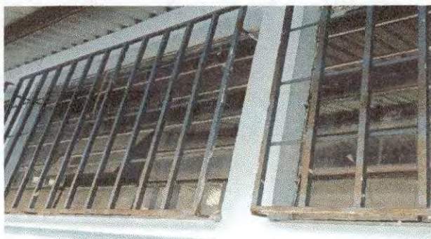
Foto 3: balcones en malas condiciones, ya no se encuentran unidos directo a la pared
