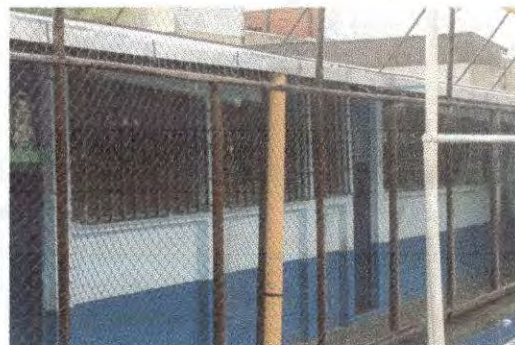
Foto 4: Malla de resguardo al módulo B deteriorada, tubos oxidados y partes quebradas
