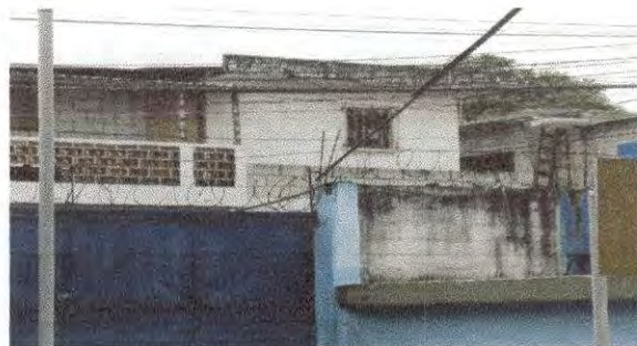
Foto 2: razón de seguridad perimetral en malas condiciones, tirado hacia afuera, soportes no colocados.
