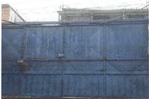
Foto 1: portón en malas condiciones, chapas dañadas
