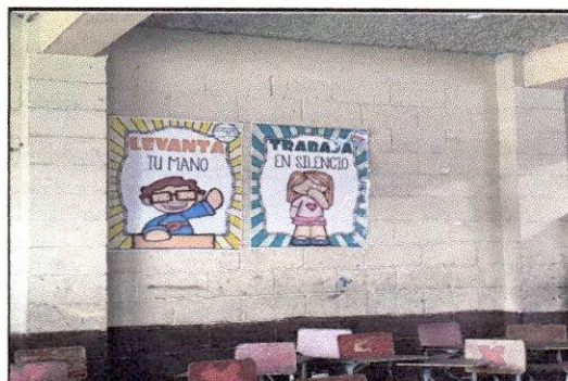
FOTO 16. Aula del modulo A con necesidad de pintura
