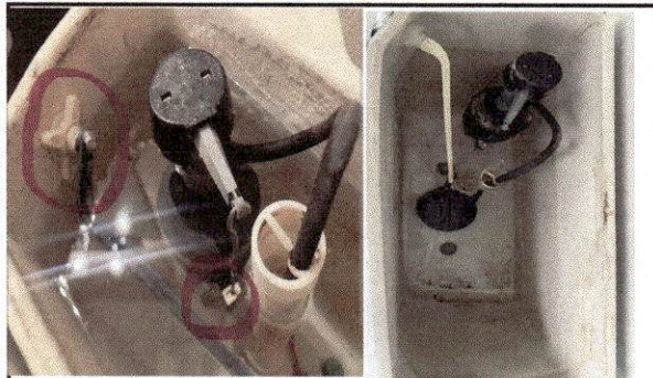
FOTO 3. piezas quebradas de 3 sanitario modulo B
