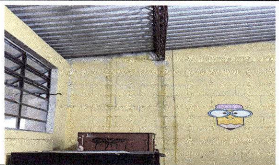
FOTO 5. Entrada de agua en la lamina
