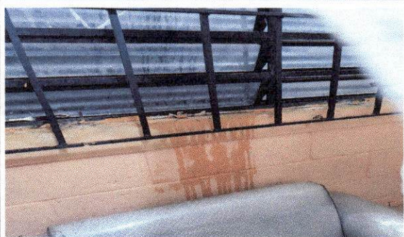
FOTO 1. ventanas sin poderse cerrar ni abrir en algunas aulas se entra el agua .Modulo A
