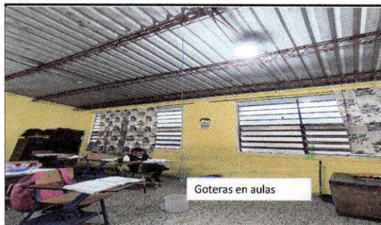
FOTO 6. Goteras en el techo de las aulas y pasillos
