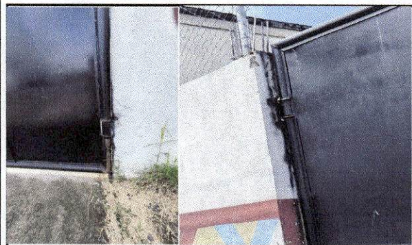
FOTO 9. visagras ,marco dañado y lamina torcida y dañada
