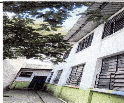
FOTO 2. Ventanas que no pueden cerrarse falta de vidrios se entran serpientes y ratones
