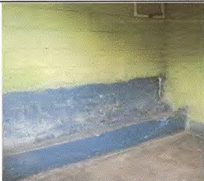
Foto 3: Pileta Mingitorio de niños pequeños. Colocar piso, azulejo y reparar la descarga para limpieza
