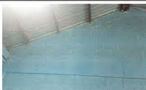
Foto 4: Filtración de agua por la unión de la lámina y a pared en Aula Segundo Nivel. Arreglo de fugas
