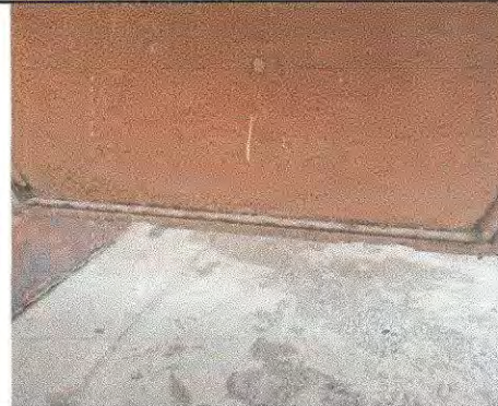
Foto 4: Reparar puerta ingreso a Mingitorio niños pequeños.
