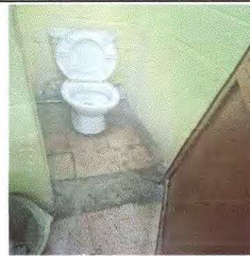
Foto 2: Bateria de baños de Mujeres de 4° a 6° grado. Cambiar piso, inodoros (3) y colocar azulejos
