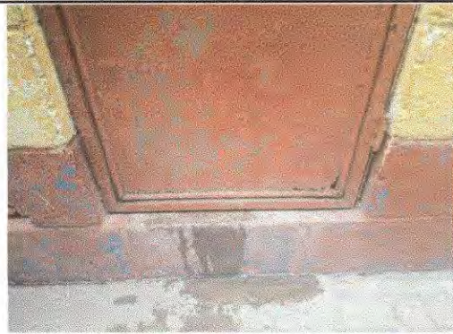
Foto 2: 5 Baños individuales Niños(as) pequeños. Reparar las puertas
