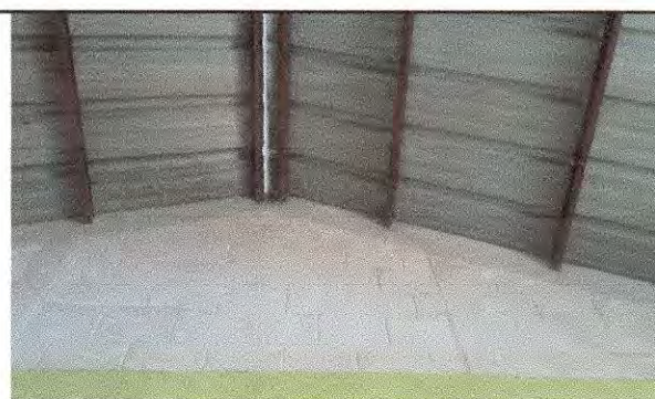
Foto 6: Filtraciones por Gotera en aulas segundo Nivel. Arreglo de fugas
