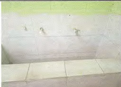
Foto 1: Bateria de baños para Mujeres de 4° a 6° grado, cabiar pileta por 2 lavamanos
