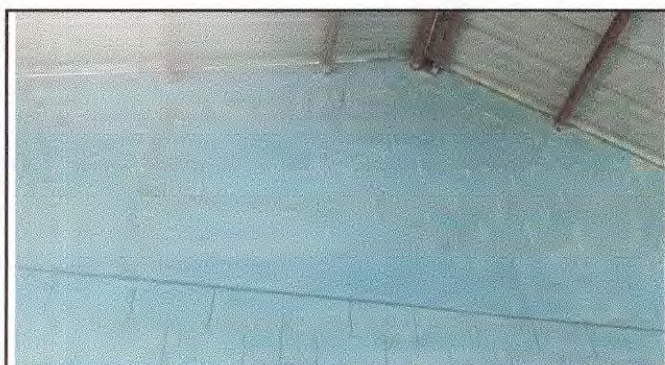
Foto 5: Filtración de agua por la unión de la lámina y a pared en Aula Segundo Nivel. Arreglo de fugas
