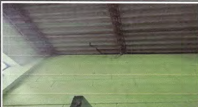
Foto 19: Baño de señoritas cambio de láminas quebradas
