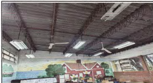
Foto1: Salón 1 cambio de 11 laminas duralita quebradas y rajadas.
