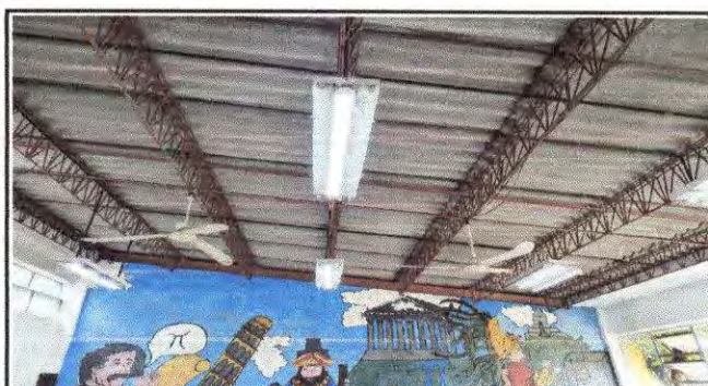
Foto 4: Salón 4 cambio de 3 laminas duralita quebradas y rajadas.
