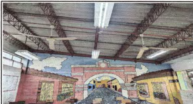
Foto7: Salón 7 solo sellado en inicio de láminas y mantenimiento de canales
