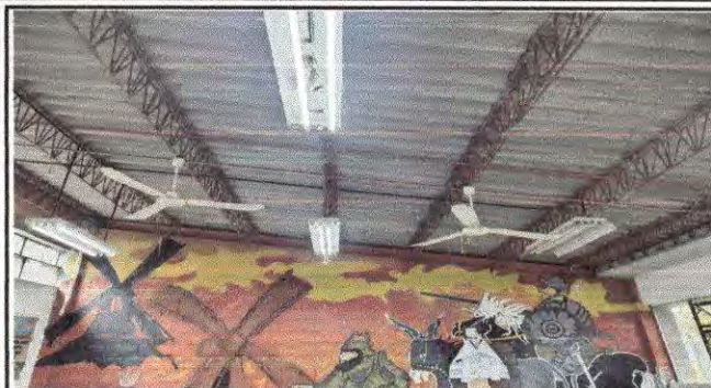
Foto 2: Salón 2 cambio de 1 lamina duralita, humedad y filtración de canales.
