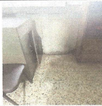
Foto 4: Humedad en Dirección, impermeabilizar, repellar y pintar
