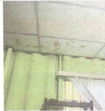
Foto 2: Cielo falso dañado en Dirección, cambio del mismo
