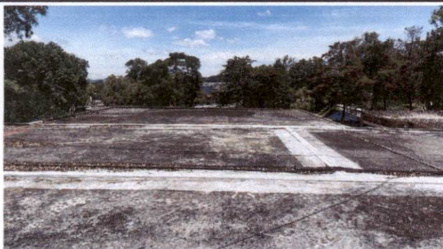
Foto 3: cuando construyeron el establecimiento instalaron un techo compuesto por secciones de loza que a cierto tiempo necesitan ser impermeabilizadas las juntas.
