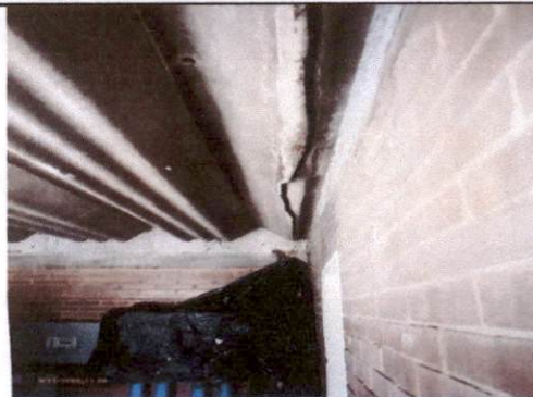
Foto 2: las goteras son mayores principalmente es el area de controles electricos de la acometida que surte al establecimiento, por lo tanto se cambiará por estructura metálica y lamina de zinc troquelada. Total 117 metros cuadrados
