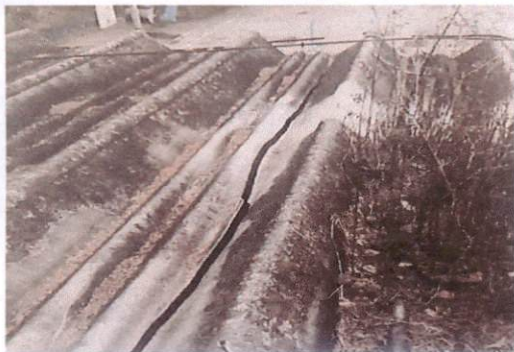
Foto 1: La durelita cumple este año 55 años y se ha producido grietas por donde la lluvia entra a los ambientes, además el polvillo que produce esta dentro de los materiales cancerígenos. Se cambiara por lamina de zinc
