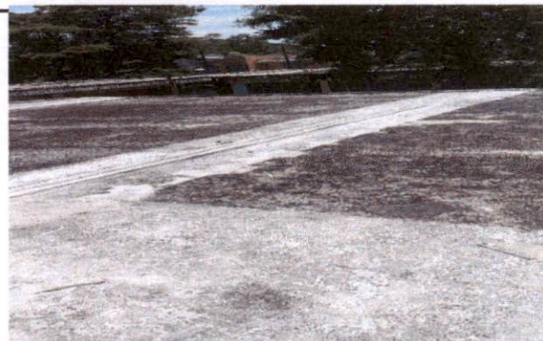
Foto 4: Las juntas del tercer pabelosn vas a lo largo de la sección de los ambientes y por aquí se filtra la lluvia.
