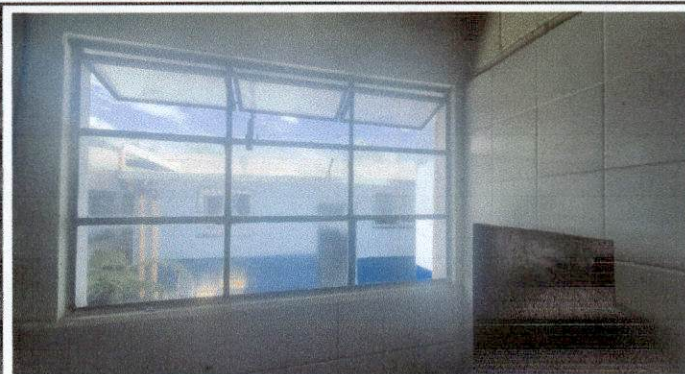
Foto 2: Evidencia de las ventanas en mal estado: Necesitan cambio
