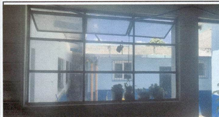
Foto 1: Las ventanas están deterioradas y los hierros oxidados.
