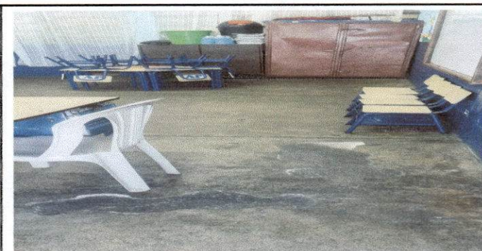
Foto 4: Evidencia del piso en muy mal estado. Necesita cambio.
