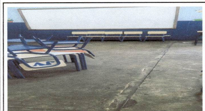
Foto 3: Esto evidencia que el piso de los salones están en mal estado.
