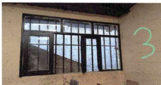
Foto 1: Sustrucción de ventana del grado de tercero a sexto.
