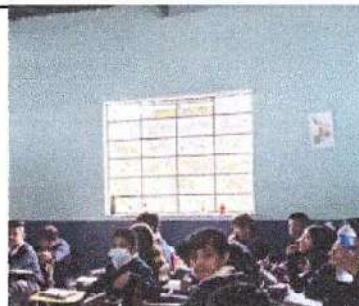
Foto 4: Ventanas a reparar de 6to. N0.1
