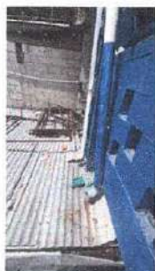
Foto 5: bajadas de agua de canales a reparar
