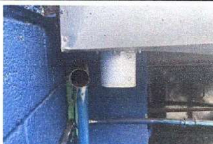
Foto1: Bajada de agua a reparar
