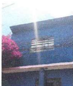
Foto 5: Ventanas a reparar de 6to. No2.
