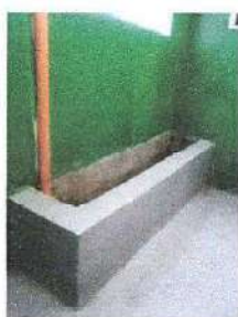
Foto 3: Servicios Sanitarios y sus accesorios (mingitorio en baño de varones)
