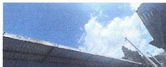
Foto 2: Canal a Reparar en el segundo Nivel de 4to. Y la ludoteca
