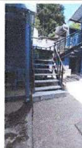
Foto 4: Canales y bajada de agua pluvial esta bajada desembocara en el drenaje
