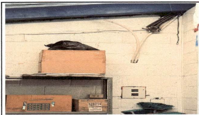
CAJA DE FLIPONES QUE ALIMENTA LA BOMBA DE AGUA
