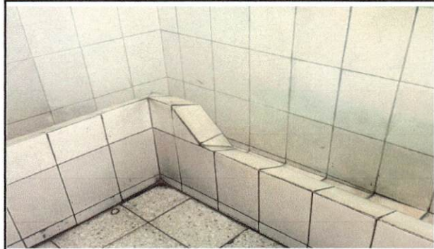
MINGITORIO DE LOS NOÑOS QUE SE LES CAMBIARA AZULEJO
