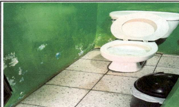
SANITARIO CON FUGAS Y HUMEDAD
