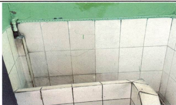
MINGITORIO DEL BAÑO DE NIÑOS DAÑADOS
