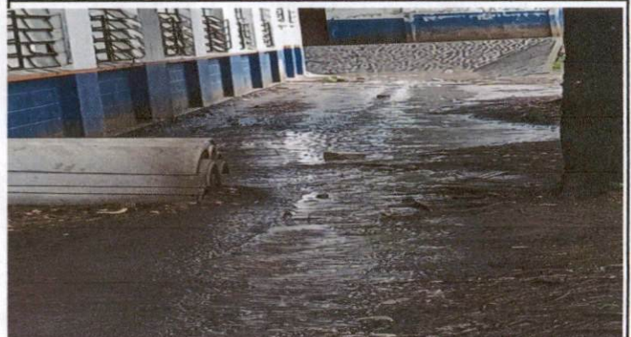
1. a. ESTA FOTO DEMUESTRA COMO EROSIONA LA TIERRA DEL TERRENO ALREDEDOR DE AMBOS MODULOS DEL ESTABLECIMIENTO, POR LO QUE CON LA COLOCACION DE CANALES SE EVITARA , EL
