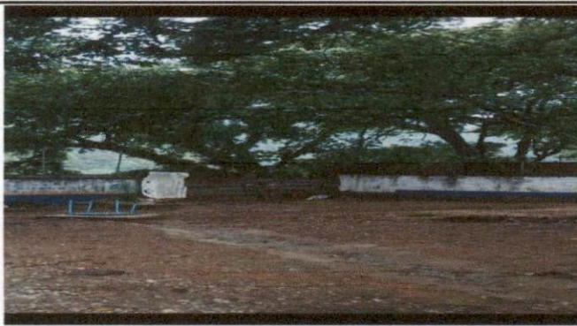
2.CERCO O MURO PERIMETRAL: SE REQUIERE LA REPACION DE MURO PERIMETRAL CONSISTENTE EN 19 MTS CUADROS, DE MURO QUE SE DERRUMBO.
