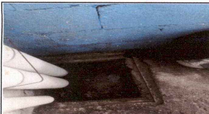
Foto 3: mantenimiento de drenaje en los baños, no tiene la capacidad para que el agua se valla directamente .
