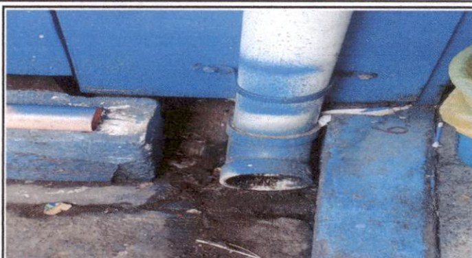
Foto 2: mantenimiento de caídas de agua, a la hora que llueve no tiene para donde correr el agua y se inhunda la parte de enfrente de los baños de los varones
