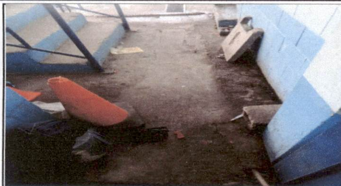
Foto1: mantenimiento de drenaje, porque a la hora que llueve se rebalsa y se va el agua para el centro de la cancha
