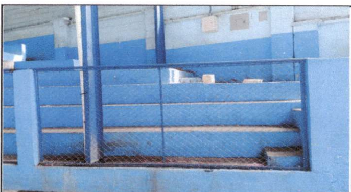
Foto 4: cambio de maya en parte interior de la cancha, ya que se encuentra floja y puede existir algun percance
