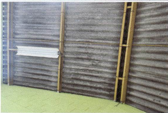
Foto 3: El techo de duralita de las aulas tiene agujeros y esto hace que cuando llueva se filtra el agua.
