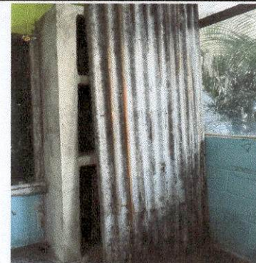
Foto 4: Los muebles que utilizan los docentes para resguardar los implementos de limpieza no tienen puerta formal (se utilizan láminas como puertas).
