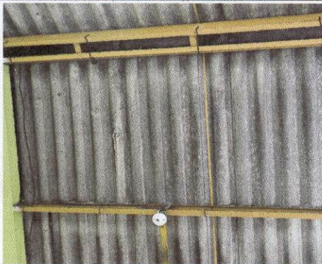
Foto 1: La duralita que tiene como techo, se esta detereorando y quebrando.
