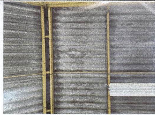
Foto 2: El techo de duralita se debe de cambiar, ya que por las lluvias se está quebrando.
