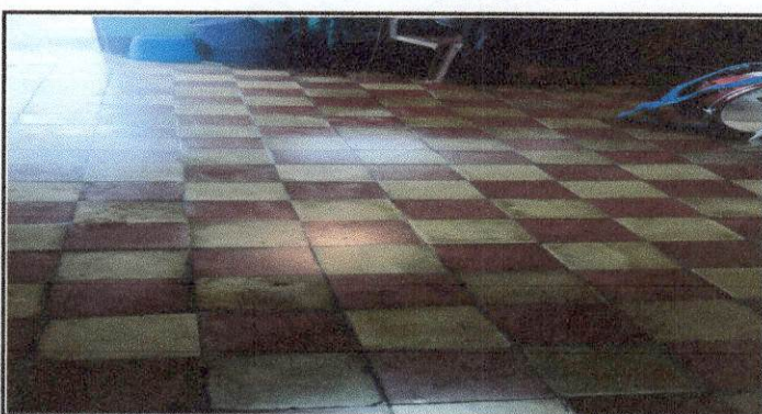
Foto 6: El piso de la cocina esta muy deteriorado, necesita cambio por piso moderno antideslizante pues el espacio lo amerita debido a que ahí se elaboran los alimentos de los estudiante
