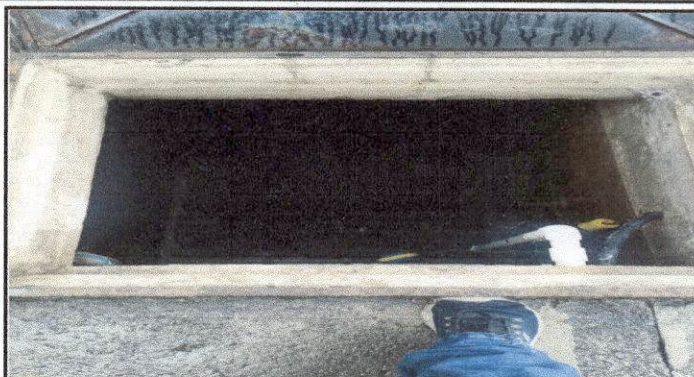
Foto 2: el cisterna cuenta con una antigüedad 35 años en los cuales no se le ha dado el mantenimiento que debería de tener por falta de recursos económicos por lo que se necesita cambio de tubería, llaves, torta de cemento interno
