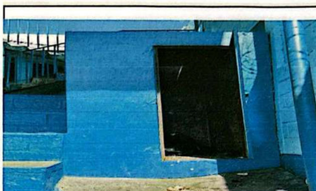
Foto 14: Puerta del depósito de basura en mal estado.
