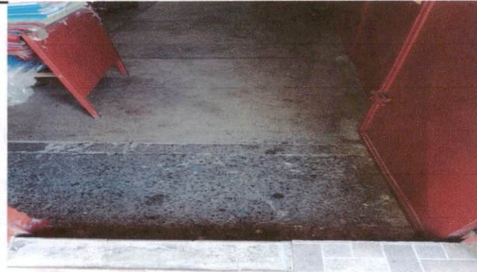
Foto 4: AULA 2 PISO DE GRANITO SEGUNDO "A"
