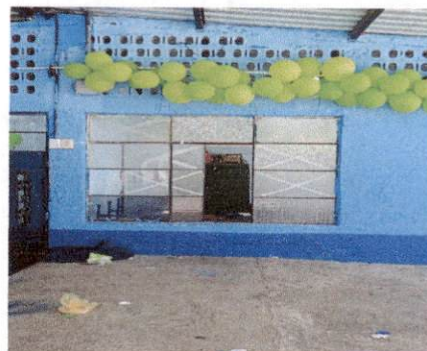
Foto 2: Cambio a ventana de metal por ventana de pvc y balcon por seguridad de los alumnos, ya que hemos tenido varios incidentes que han quebrado vidrios por no tener balcon. Salon 10
