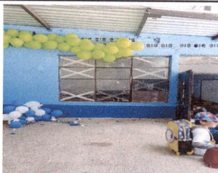
Foto 3: Cambio a ventana de metal por ventana de pvc y balcon por seguridad de los alumnos, ya que hemos tenido varios incidentes que han quebrado vidrios por no tener balcon. Salon 10
