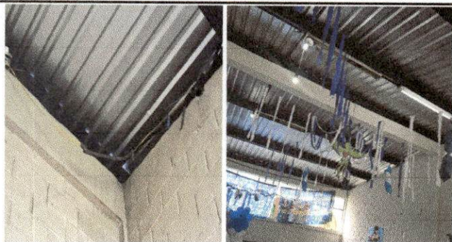
Foto1: Nivel 2 las clases cuentan con 4 bombillo con poca iluminación y cables al exterior . Se cambiara el cableado electrico y se pondrá luces led.
