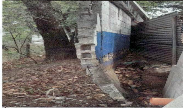
1.1 EVIDENCIA LA URGENCIA DE RECONSTRUIR EL MURO PERIMETRAL
