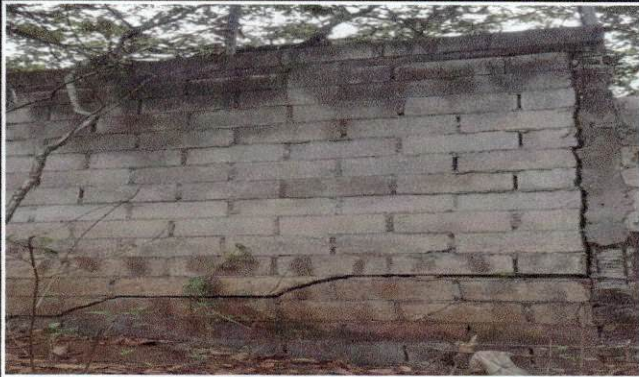
1. CERCO O MURO PERIMETRAL: SE PUEDE OBSERVAR LAS GRIETAS PROXIMAS A DESPLOMARSE.
