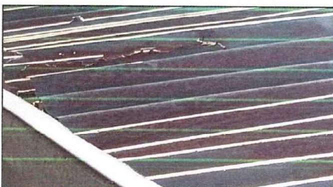
Foto 4: En la fotografia se evidencia el deterioro de la lamina, donde existe filtracion hacia adentro de las aulas.
