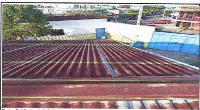
Foto 5: Vista del deterioro de la lamina y capote, por los años que lleva colocada desde su instalacion.
